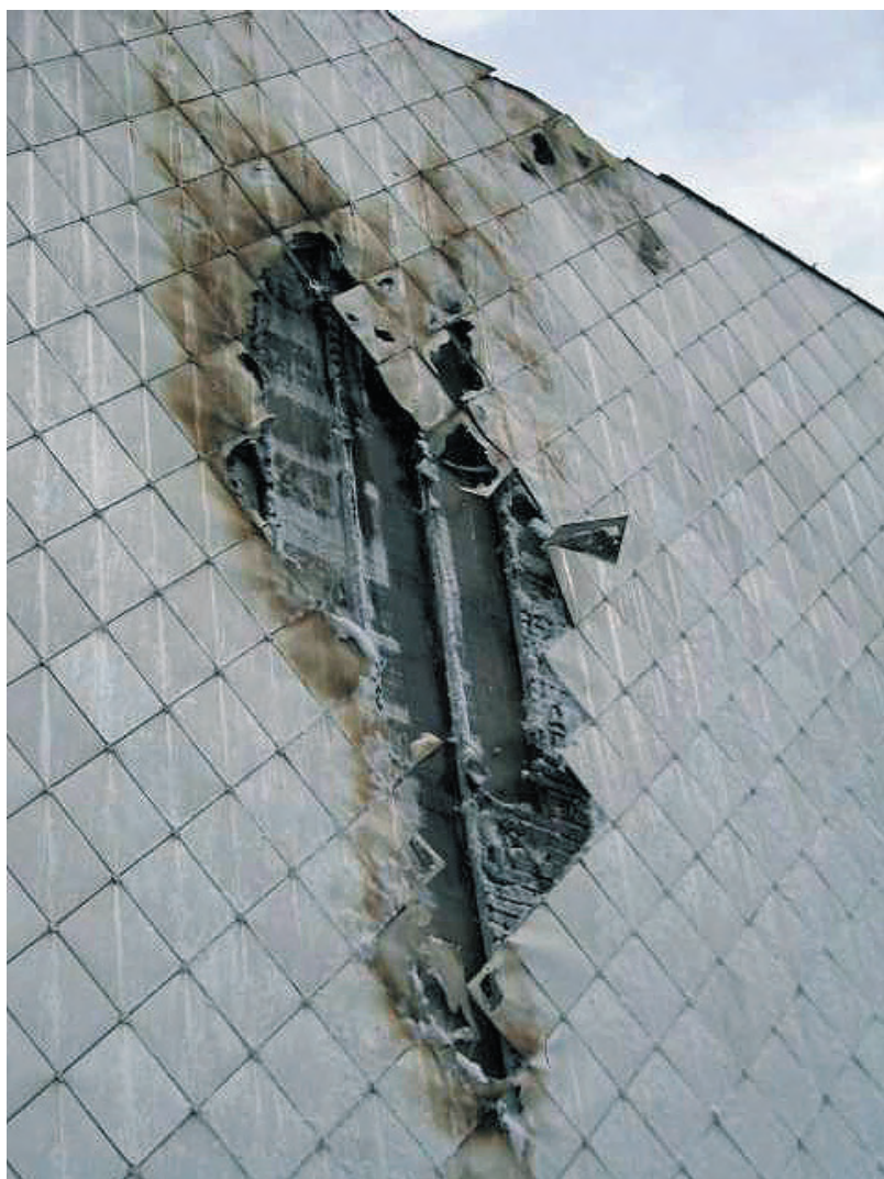
Abb. 8.7: Bei Deckarbeiten auf dem Dach züngelte die Flamme eines Propangasbrenners in den Fassaden-Hinterlüftungsraum und entzündete die Mineralfaserdämmung.
