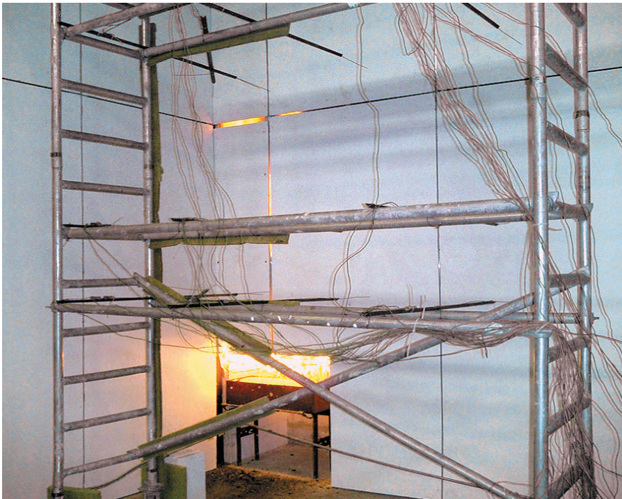
Abb. 8.8: Beginn eines Brandversuchs: Oberhalb der Flamme ist eine hinterlüftete Fassade originalgetreu aufgebaut.
