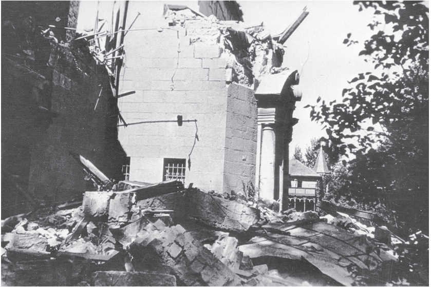
Abb. 5: Kiel, Kunsthalle. Das zerstörte Hauptportal am Düsternbrooker Weg 1942. Im Hintergrund die Hegewisch-Villa „Klein Elmloo“.
